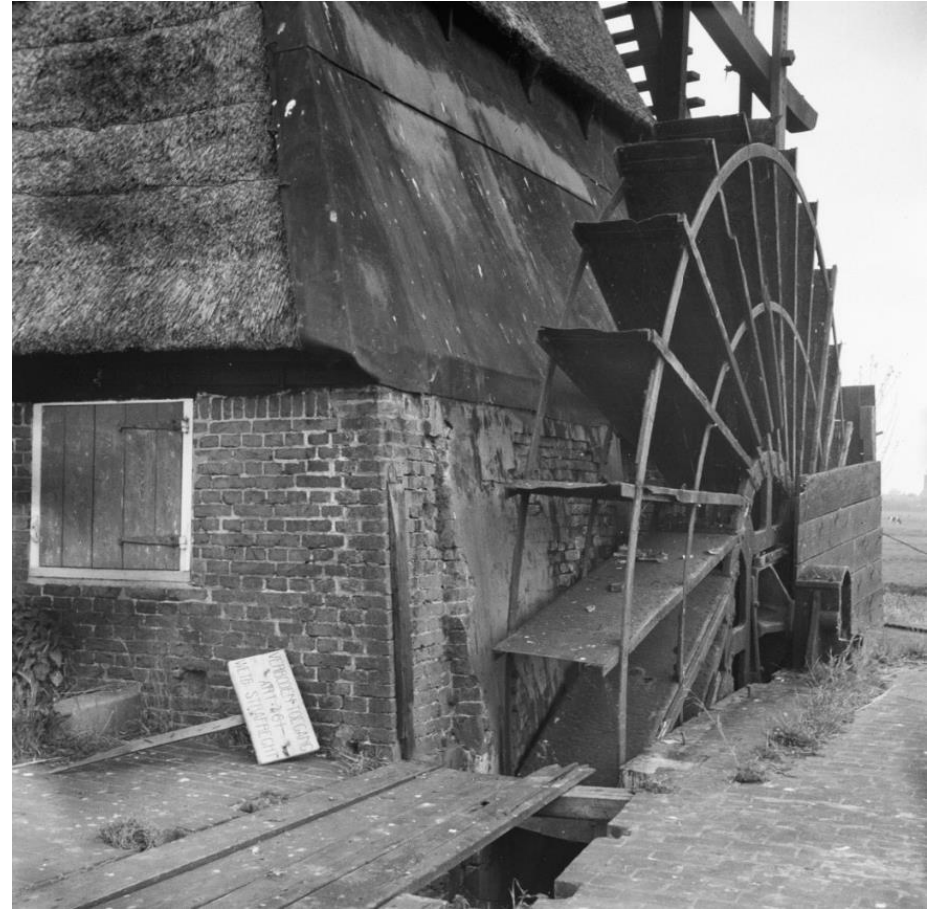
afb. 45 Het scheprad van de Sluismolen in vervallen staat, juni 1962
