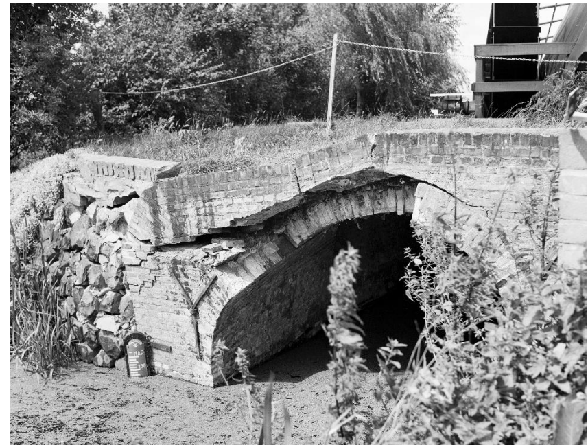
afb. 8 Het ingestorte metselwerk van de achterwaterloop, 1980
